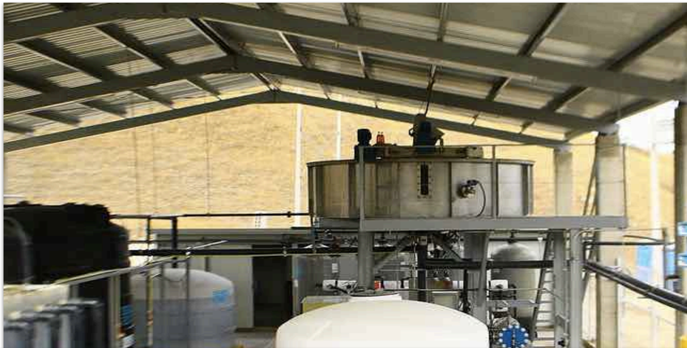
Proyecto especial, PTAR para el tratamiento de los lixiviados del relleno sanitario "Picachos" en Zapopan 6.5 L.P.S.
